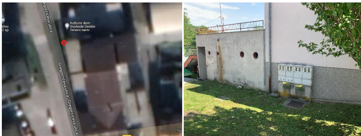
Slika 6: Lokacija zunanje elektro omare (levo), zunanja elektro omara (desno)
