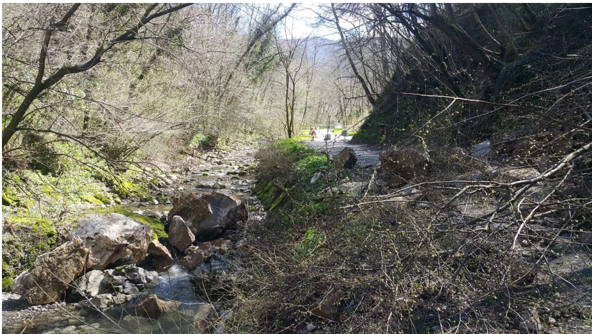
FOTO 3: Porušen material na cestišču takoj po dogodku
