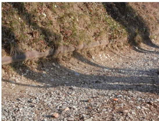
Slika 2: obstoječa vodovodna cev
