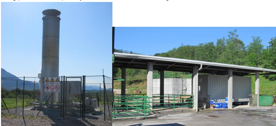
Slika : Čistilna naprava na princip reverzne osmoze in bakla za sežig odlagališčnega plina
